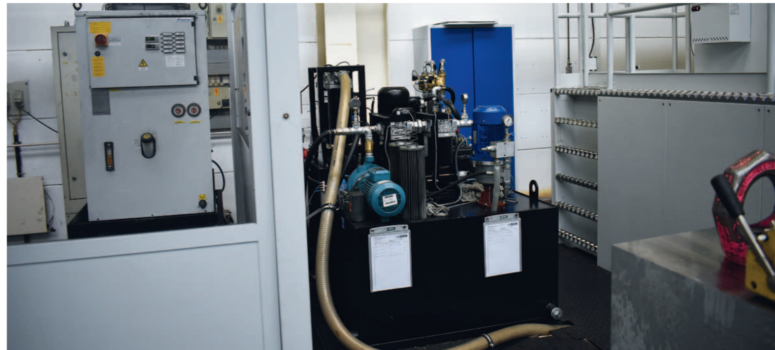
Kombinierte Kühlmittelanlage, die sowohl für die ECOMILL wie auch die Umill 1800 genutzt wird
